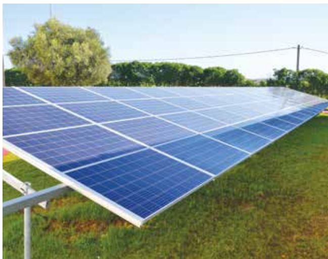
• Afin de maîtriser son empreinte environnementale, le groupe Silver Food a investi dans une installation photovoltaïque devant couvrir à court terme 40% des besoins en énergie de l'usine.
